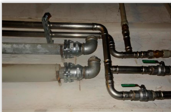
Przykład zastosowania specjalistycznych żeliwnych flansz zaciskowych dużych rozmiarów na instalacji stalowej
